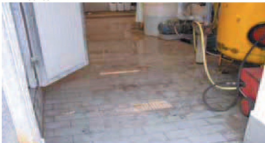
Esempio di superficie scivolosa e sdruciolevole: insufficiente drenaggio con pericolosi ristagni d'acqua.
